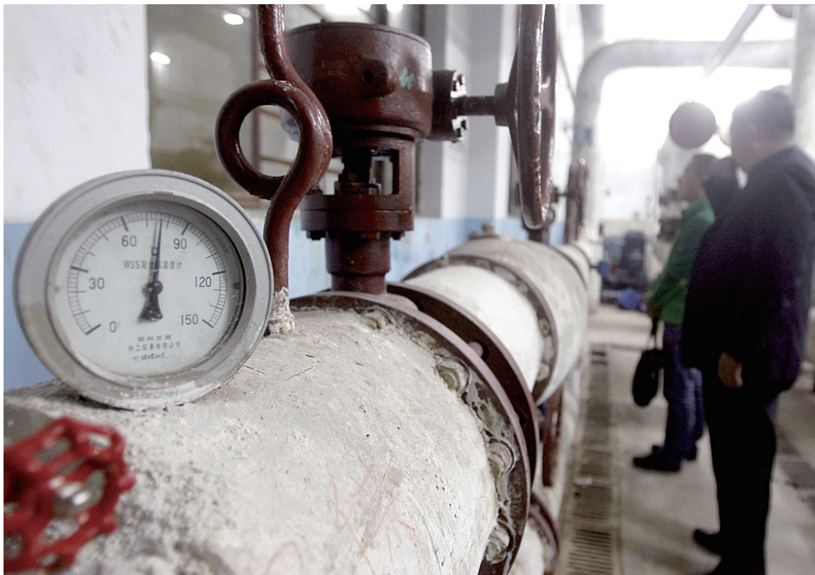
核五院热交换站的温度力表上显示着实时水温。
