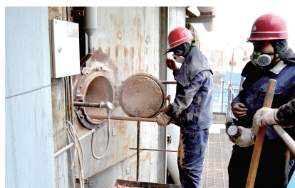
工作人员检查热力设备
