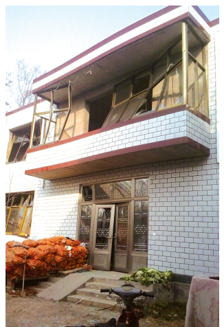
朱家邻居房屋也遭到重创
