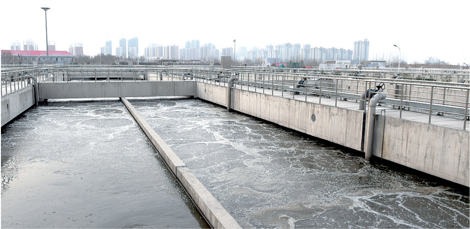
中原环保旗下的一污水处理厂的污水处理池
