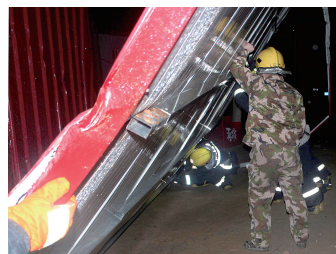
温室大棚倒塌
