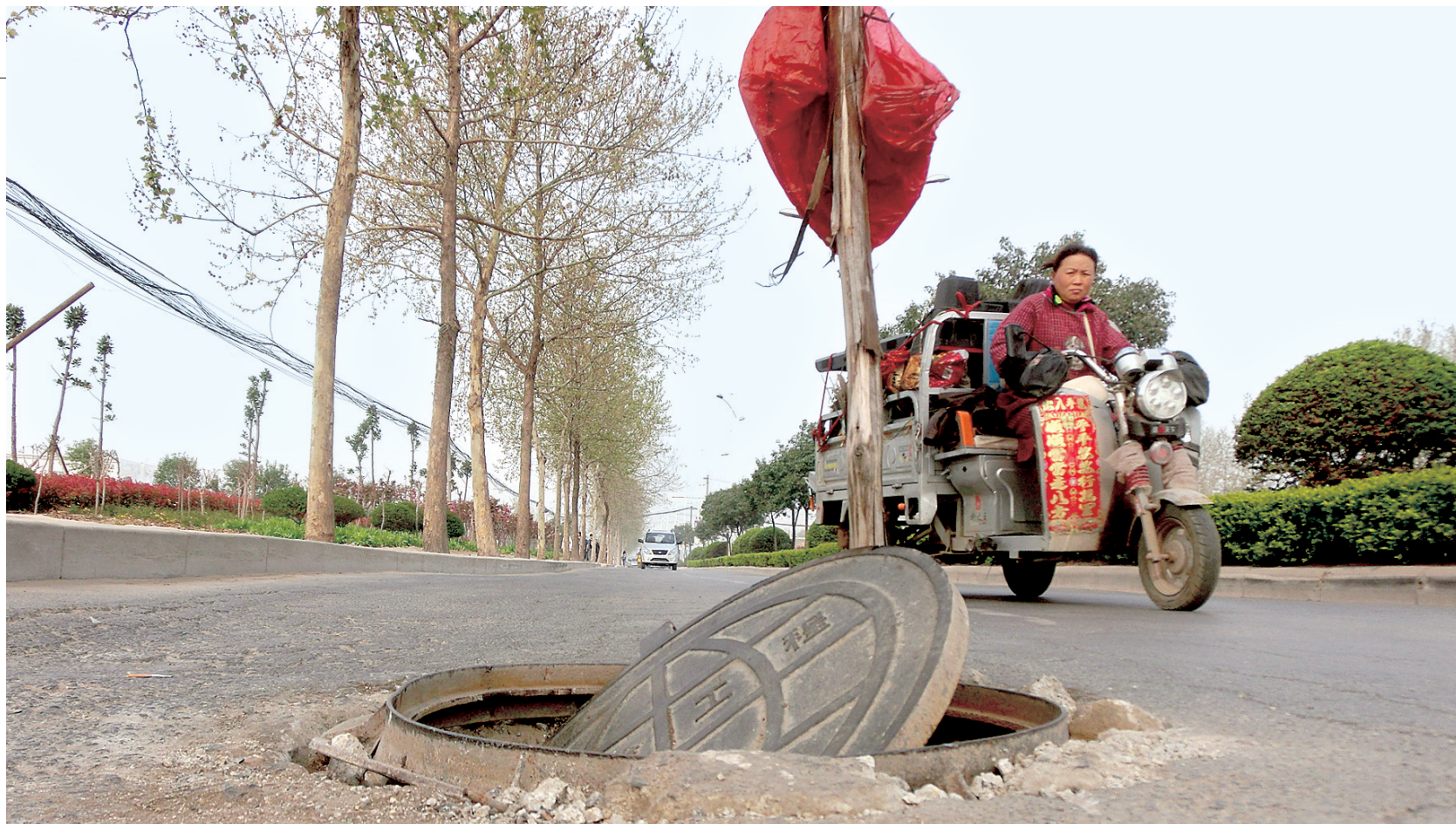
昨日上午,记者在建设西路富民路口拍到的一处危险窨井。郑州晚报首席记者 徐富盈 图
