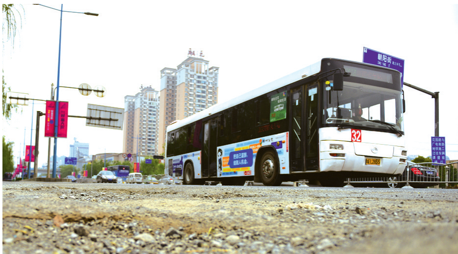
花园路和渠东路交叉口,路面出现病害
