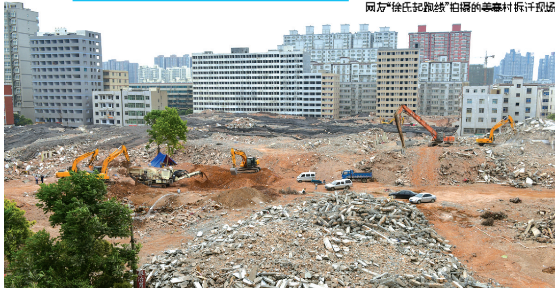
不少建筑垃圾没有覆盖防尘网
