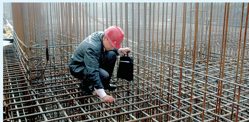
荥阳市建设工程质量监督站工作人员正在对项目钢筋进行现场检查
