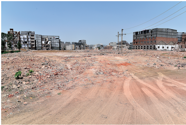
工地上,大面积黄土裸露
