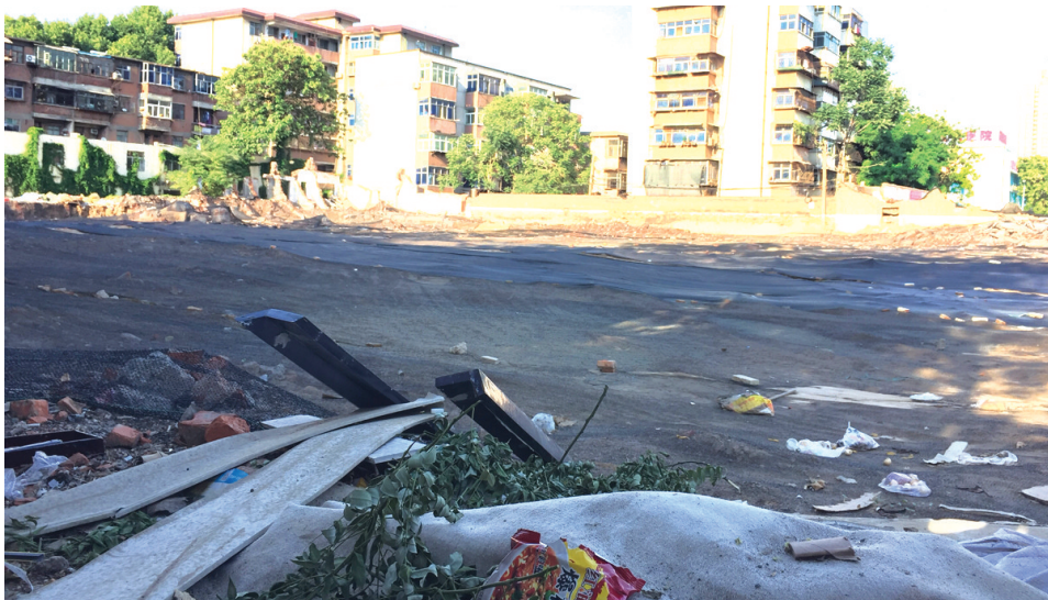
西站路与桐柏路交叉口西北角待建工地内盖上了防尘网,但围挡醒目位置未见环保标识牌。
