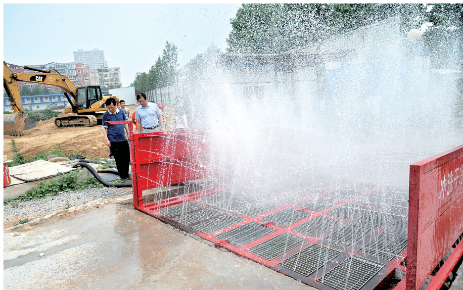
中原区一建筑工地出入口安装的喷淋降尘设施
