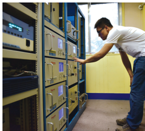
监测总站人员在养护监测设备
