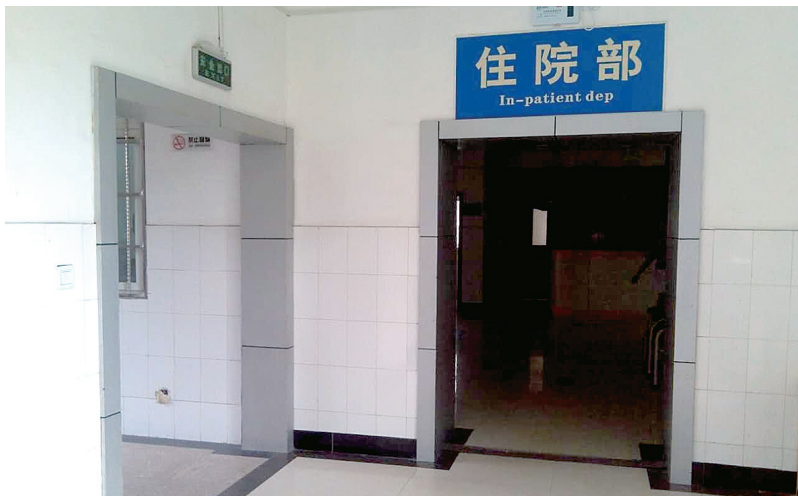
圃田乡卫生院走廊未安装防火门
