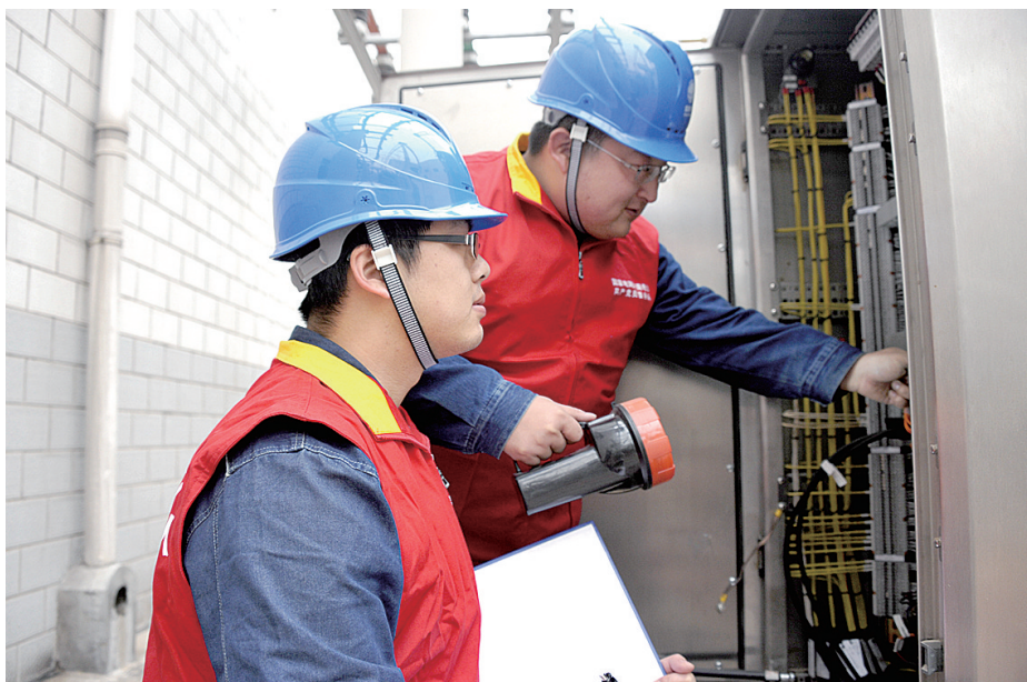
工作人员对供电设备开展特巡
