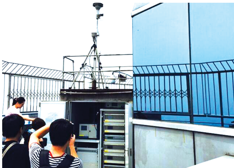
市属媒体记者参观石家庄市电视塔200米高处的大气梯度监测站
