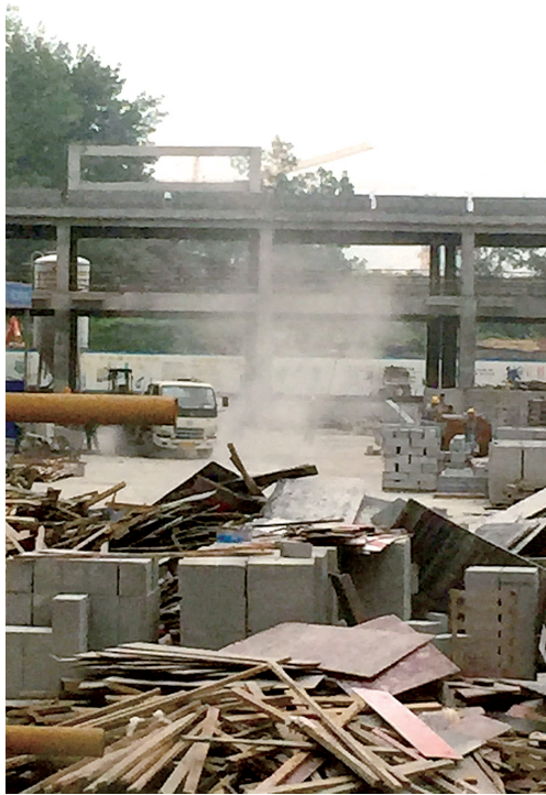
市民反映,位于文化路开元路西侧的民安·北郡施工项目存在扬尘问题。
