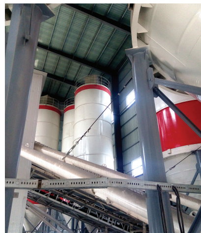
水泥罐上安装的收尘器
