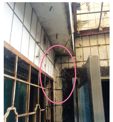
火灾导致水管烧坏
