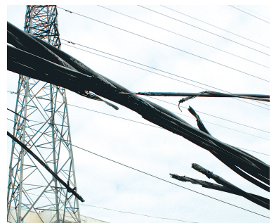
高压线被烧坏
