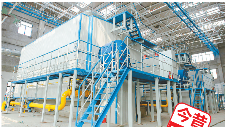
改造后的政七街燃气锅炉房车间
