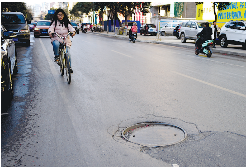
商城路和未来路交叉口西边的一个窨井盖下沉
