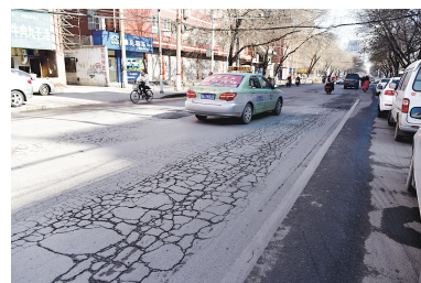
路口东边的路面破碎，呈龟壳状
