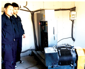
等不来维保人员,宾馆另找人检修电梯
