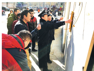
墙上乱拉的电线要清理
