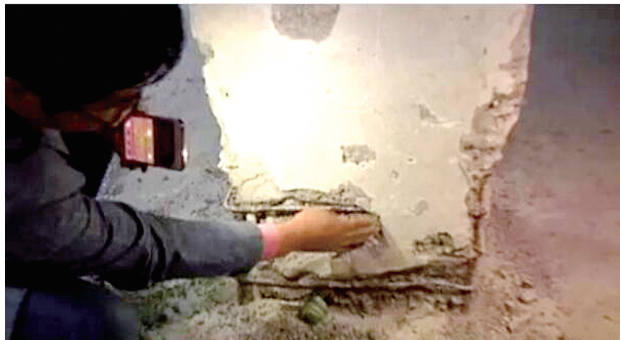
承重墙用手能抠掉水泥沙块
