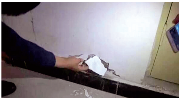
业主指着一处墙体裂纹
