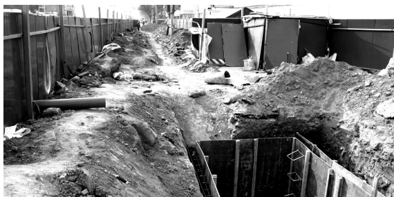
西站路电缆入地施工工地没作任何覆盖
