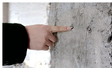
墙内的钢筋也被砸断破坏
