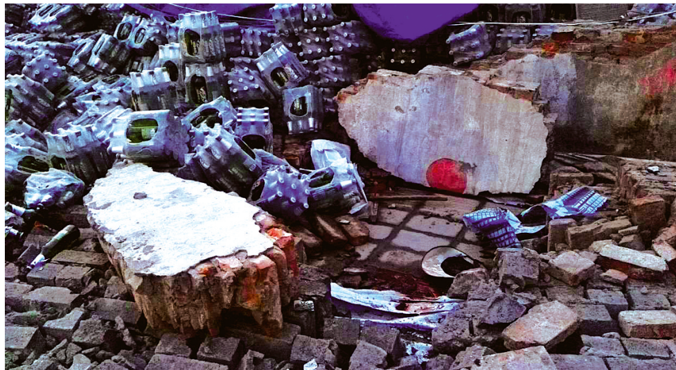
围墙倒塌现场
