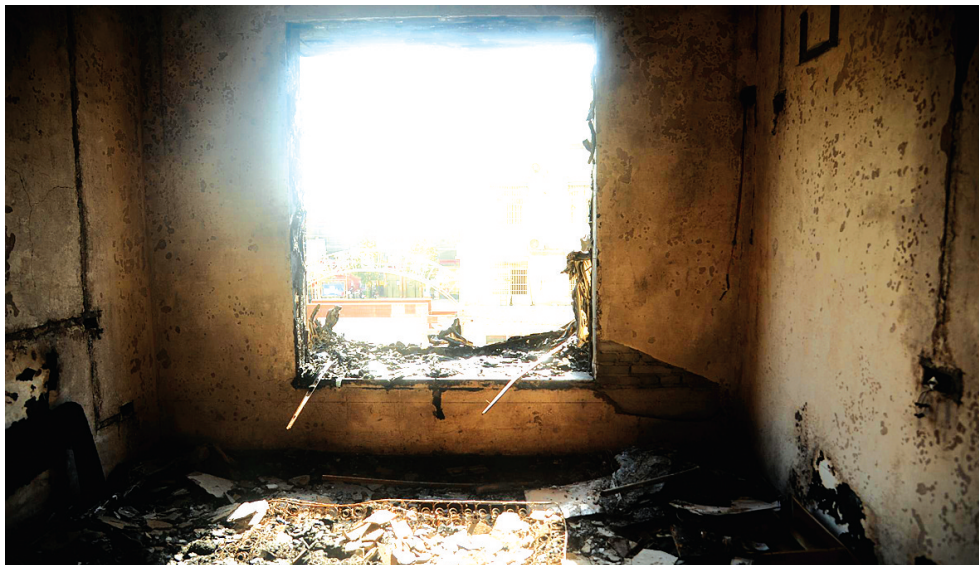
被焚烧殆尽的居室
