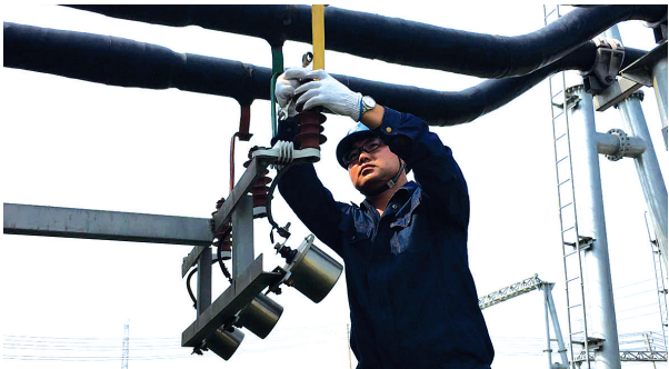
检修工区人员正在对变电站避雷器例试
