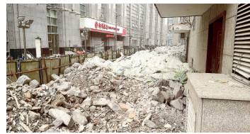
装修垃圾占去半幅通道
