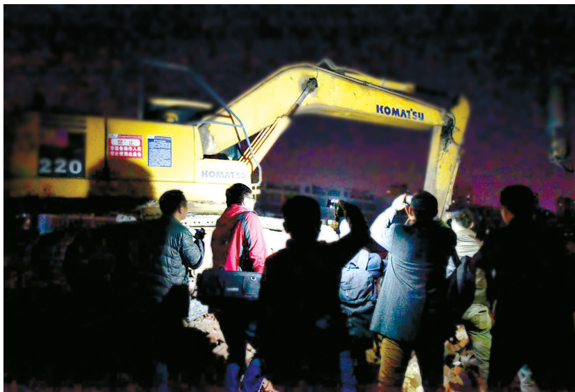
庙李村违规施工被查处
