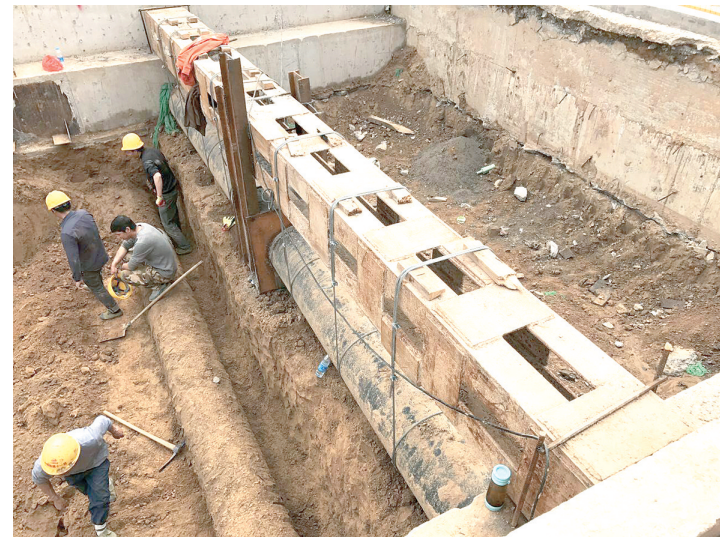
巡线员要经常到这样的现场,工作中不穿裙子高跟鞋
