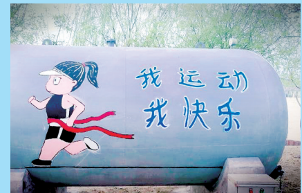
美吧,供水装置换了新衣
