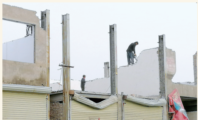
大河路附近一建筑物拆迁工地不洒水
