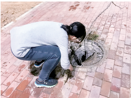
3月21日,郑州城市职业学院西500米窰井盖破碎,过路市民找来树枝提醒大家
