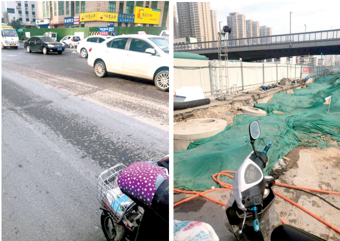
洒水后,桐柏南路上仍能看到黄土 工地上黄土裸露
