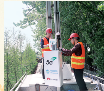
检测搭建的5G基站
