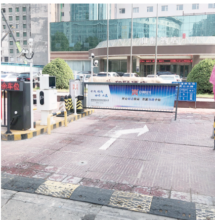
和颐酒店出入口路面不平且油污
