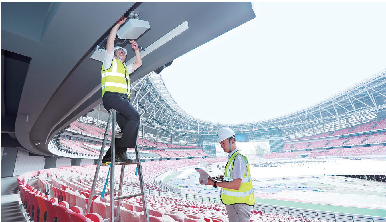
在奥体中心检测网络设备
