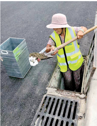
张先宇掀开井盖掏垃圾
