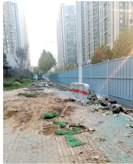
政通路兴华街美丽街区改造提升项目一挖掘机违规破路
