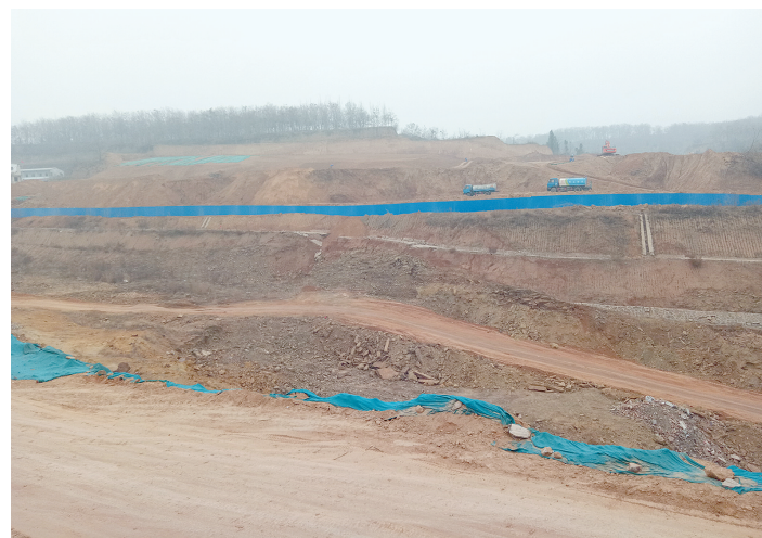
S233-S315连接线新建工程大面积黄土裸露
