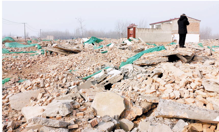
冯堂办事处楼赵村大面积建筑垃圾露天堆放
