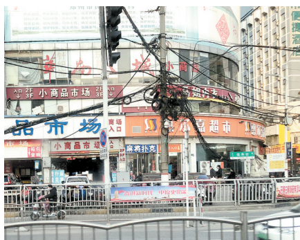
福寿街路边电缆线杂乱
