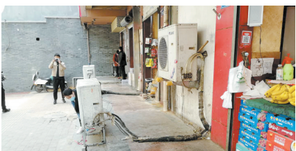
永安街商户空调污损,设置不规范
