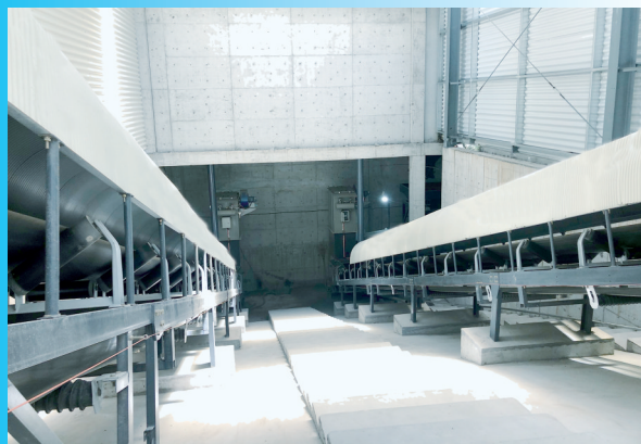
生产车间内的原料运输全部在皮带廊内完成
