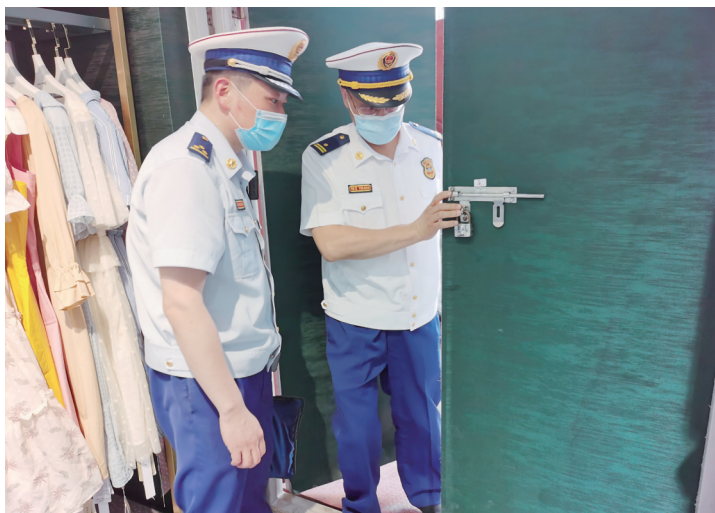
消防通道不畅通
