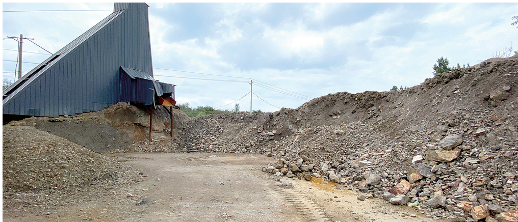
新密永安黏土矿工地砂石裸露
