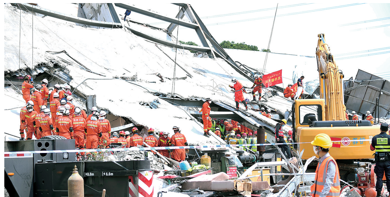
泉州市鲤城区欣佳酒店坍塌事故搜救现场 新华社发
